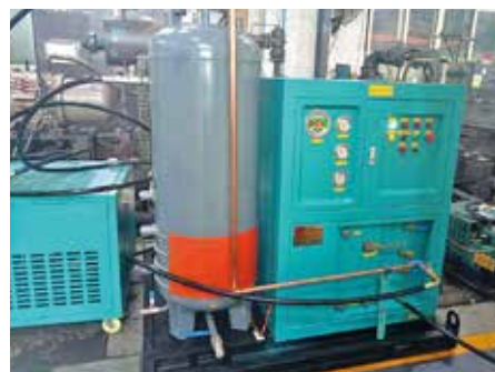
压缩机测试台冷媒回收油分离
