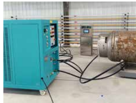
国内制冷剂工厂余气回收
