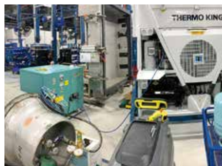
R23特高压冷媒回收再利用
