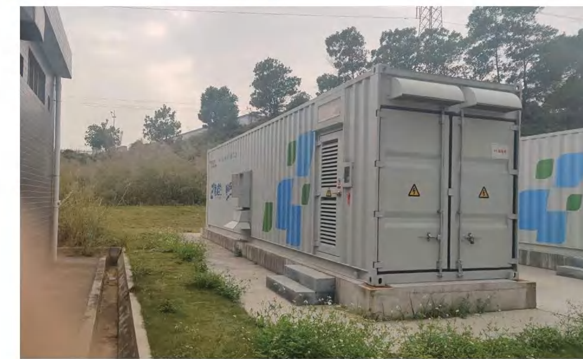
Контейнер для батарей
