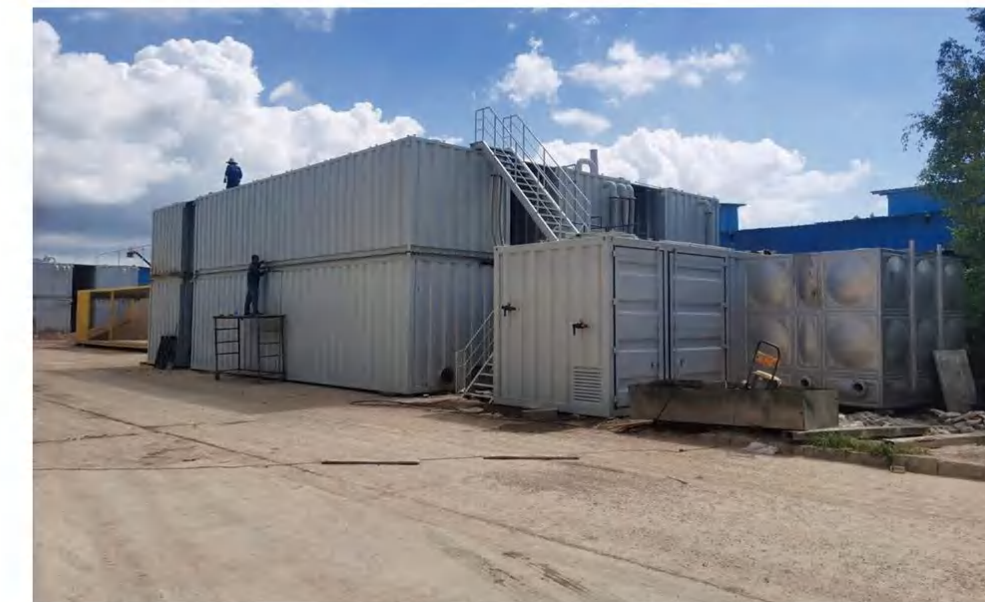
Контейнер для фильтрации сточных вод
